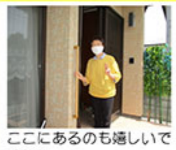
転倒を心配していた子供さんの計らいで、外と内に手すりを設置しました♪
